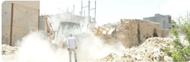
تخریب ملک مخروبه کوچه رجایی
